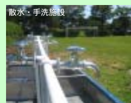
散水・手洗施設
